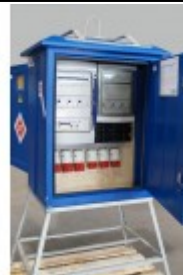
Baustromverteiler 250A:3xCEE5x63A, 3xCEE5x32A, 3x-CEE5x16A,6x230V16A Schuko
